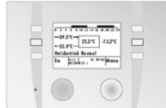
Masterbedienung MB6402 BAR (In der Schaltschranktür)
